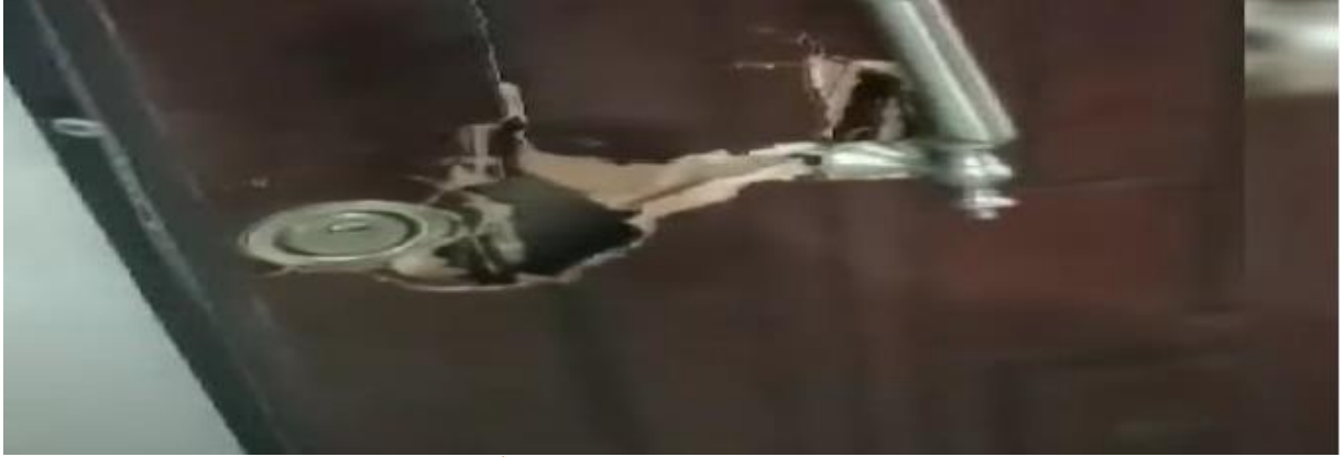
Şekil/39 Şekil 36'daki Vatandaşa Ait Olduğu İddia Edilen Evin Kapısının Gözaltına Alınma Sırasında Kırıldığına Dair Görsel
